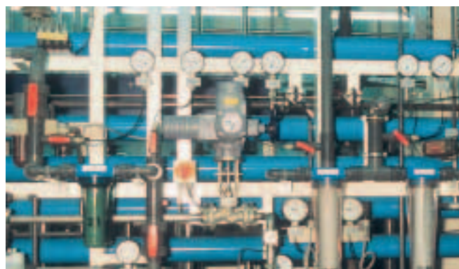
Привод AUMA, работающий в режиме регулирования. Смонтирован на регулирующую задвижку на опреснительном заводе.
