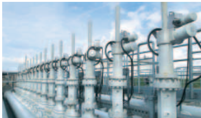
Взрывозащищенные приводы, система распределения сырой нефти по резервуарам. Нефтебаза на севере Германии
