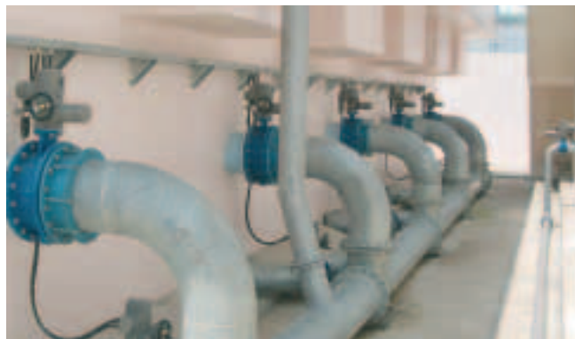
Неполнооборотные приводы AUMA, установленные на поворотные затворы в установке для обработки воды во Вьетнаме.
