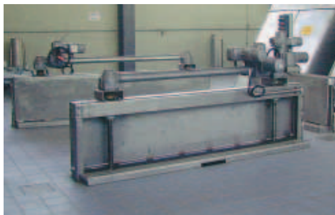
Несколько задвижек с двумя штоками на заводе по обработке сточных вод
