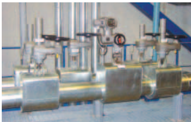
Пять задвижек, управляемых вручную и оснащенных цилиндрическими редукторами GST. Задвижка, автоматизированная с помощью многооборотного привода AUMA, на нагревательной электростанции
